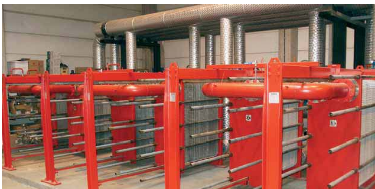
Les échangeurs de chaleur à la centrale géothermique de Saint-Ghislain.
